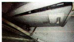
ar condensador (11).jpg
