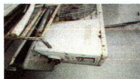
ar condensador (10).jpg
