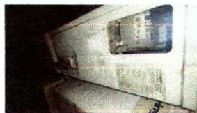
ar condensador (3).jpg
